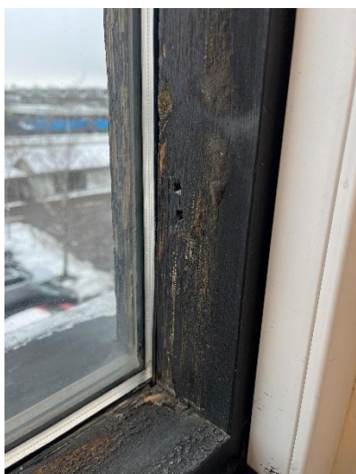
Eksempel på vindue hvor ruden ikke slutter tæt i karmen
